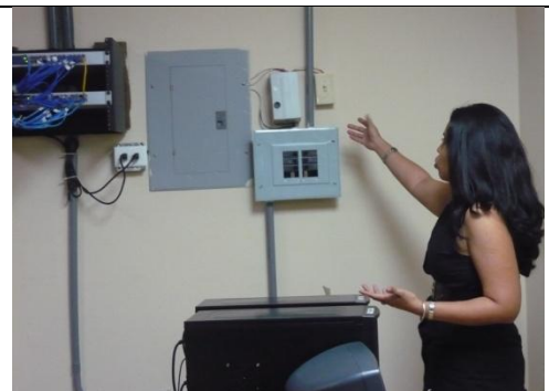
La profesora Mevis nos muestra algunos detalles en el panel eléctrico del laboratorio, hay conexiones directas que deben mejorar.
