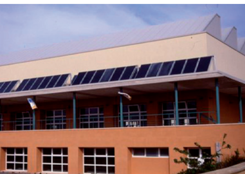
Fig. 10.27 Plaques solars instal·lades a La Universitat de les Illes Balears.
